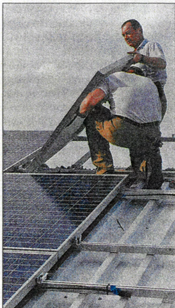
Das Wirtschaftsgebäude wird zurzeit mit PV-Modulen bestückt.
